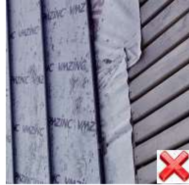
Örtü, havalandırma kesitini engelliyor.
